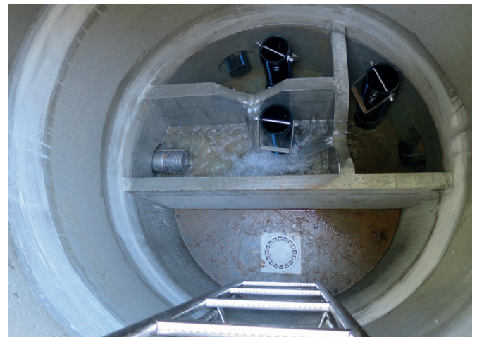
Вид изнутри: изготовленный компанией Wyss AG каптаж диаметром DN1500 с несколькими приточными и сточными патрубками и 4 камерами, установленный в общине Вицнау на Фирвальдштетском озере
